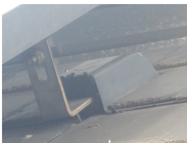
Detail van een bevestigingssysteem van zonnepanelen.
