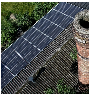
Zonnepanelen op een dak van asbesthoudende golfplaten. Deze toepassing is niet toegelaten.
