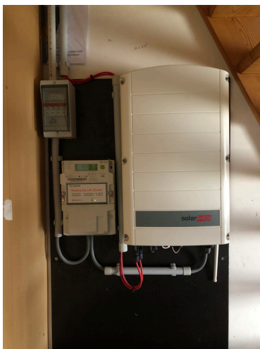
De elektrische installatie met de omvormer in het interieur.
