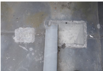
Plaatselijke herstelling: een nieuw stuk zink werd gesoldeerd ter plaatse van een lek.
