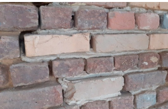
Vervang verweerde bakstenen door gelijkaardige stenen
