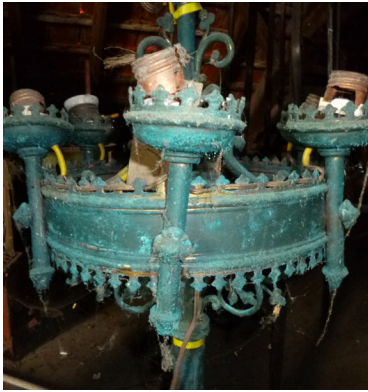
Corrosie van metaal door hoge RV. ②
