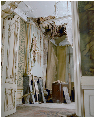
Zware schade door onthechting van het stucwerk met de drager. Foto: beeldbank Rijksdienst voor het Cultureel Erfgoed - 299.584 (CC BY-SA 3.0)
