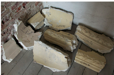
Afgebroken onderdelen van een lijst uit stucwerk. Foto: beeldbank Rijksdienst voor het Cultureel Erfgoed - 501.346 (CC BY-SA 3.0).
