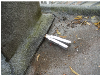
Lek in aansluiting met een schoorsteen.
