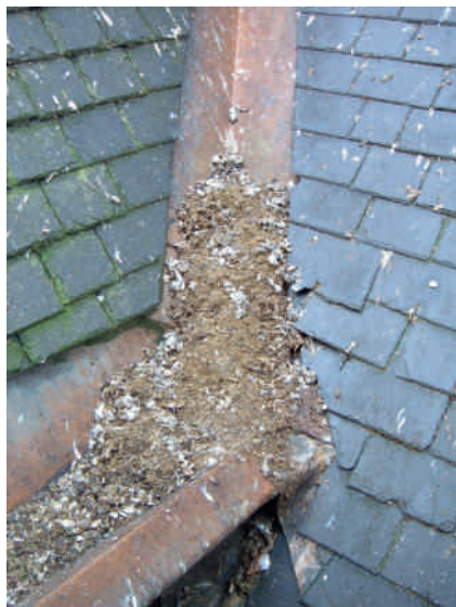
Duivenmest is corrosief
