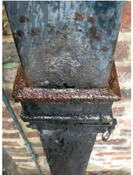
Koper veroorzaakt roest aan de onderliggende gietijzeren standpijp
