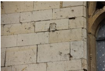
Afschaling van het oppervlak kan optreden ten gevolge van een onderbroken waterwerende laag.
