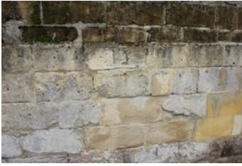
Zouten kunnen verpoedering veroorzaken, hier in combinatie met sterke biologische groei in de bovenliggende zone.
