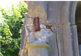
Vervang roestige doken door corrosiebestendige materialen.
