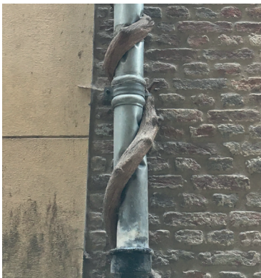
Blauwe regen is in staat om zinken regenwaterafvoer te wurgen waardoor een vlotte hemelwaterafvoer verhinderd wordt. Dikker wordende stengels zullen de regenpijp op termijn lostrekken uit de muur.
