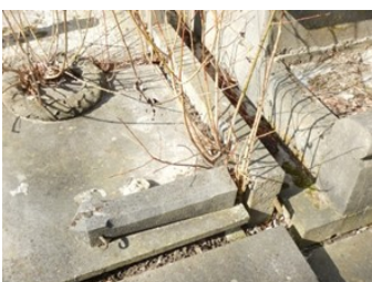
Openstaande voegen laten water toe in de ondergrondse constructie
