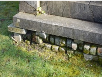
Beschadigd dragend metselwerk
