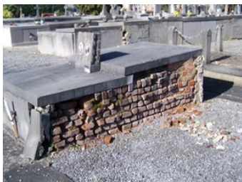
Beschadigd baksteenmetselwerk in de sokkel
