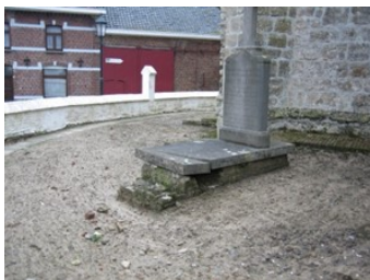
Fundering komt boven maaiveld bij terreinerosie
