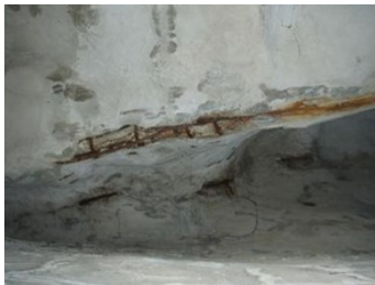
Roestende wapening is de belangrijkste oorzaak van schade aan cementrustieke elementen.
