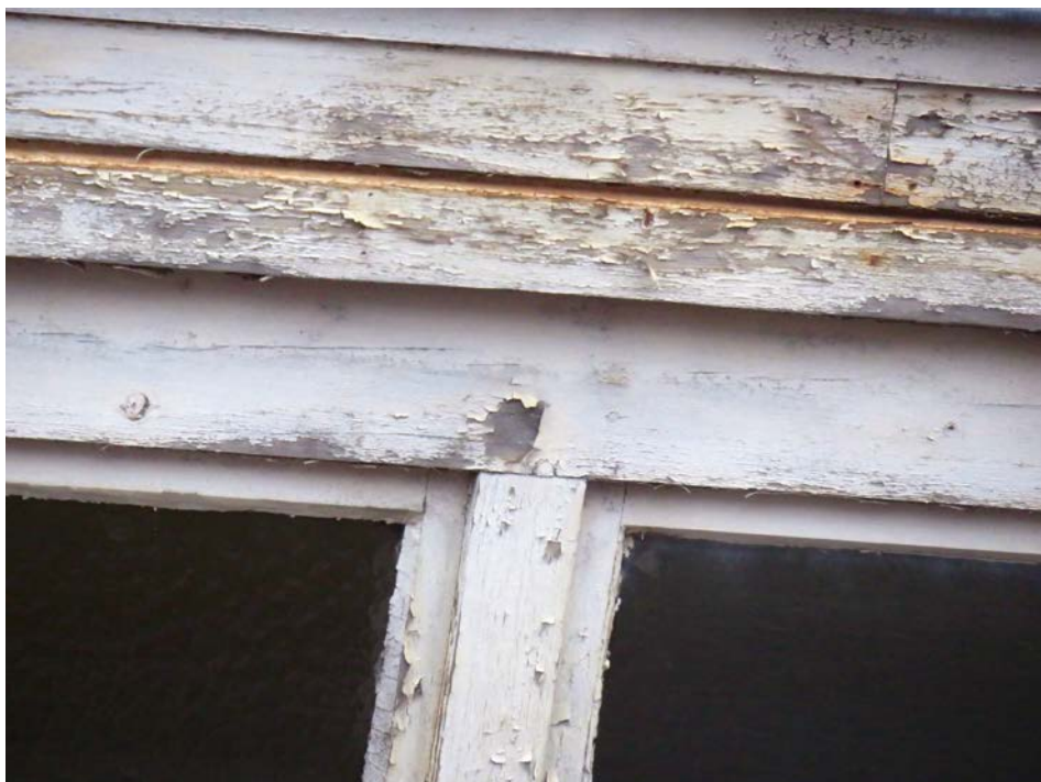
▲ Houten raamkozijn met afpellende verflagen
