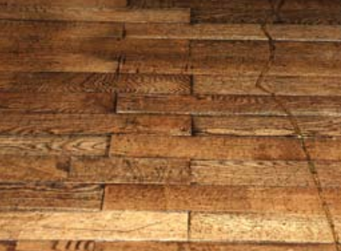
Krassen door het verschuiven van meubelen
