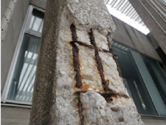
Schade aan beton heeft vaak te maken met roestige wapening en vice versa.
