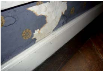
② Mechanische schade
