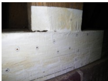
Detectiepapier op balken. Na het uitvliegseizoen zijn de nieuwe uitvliegopeningen aangeduid.
