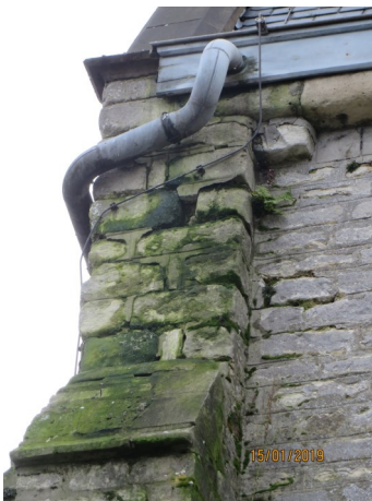
Het afbladderend schilderwerk en de mosvorming wijzen op een lek.
