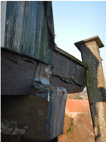
Achterstallig schilderwerk op structurele balken
